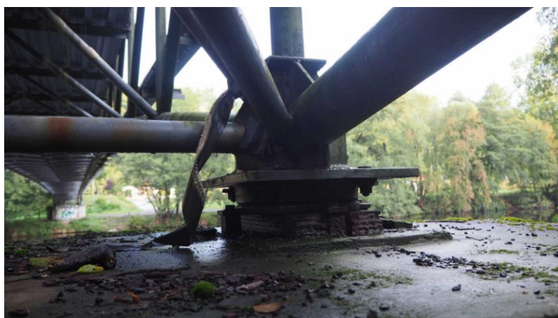
Detail ložiska na levobřežním pilíři s korozí ocelovým podložek.
