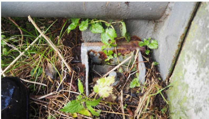
Detail koroze ložiska na pravobřežní opěře a uchycená vegetace v jeho okolí.
