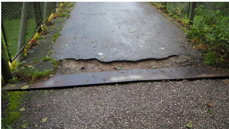
Výtluky v asfaltu u levobřežní opěry spolu s obnaženým krycím plechem dilatace.
