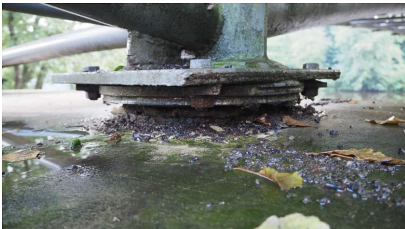
Koroze ložiska na pravobřežním pilíři.
