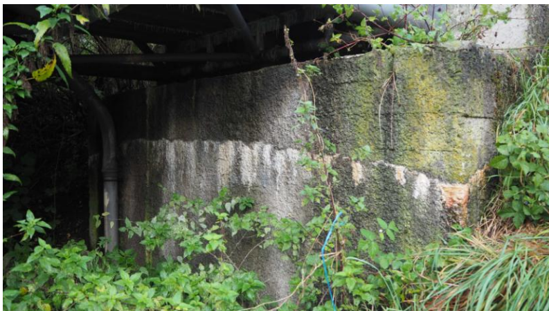
Pravobřežní opěra zarostlá vegetací a s vodorovným průsakem pracovní spárou .
