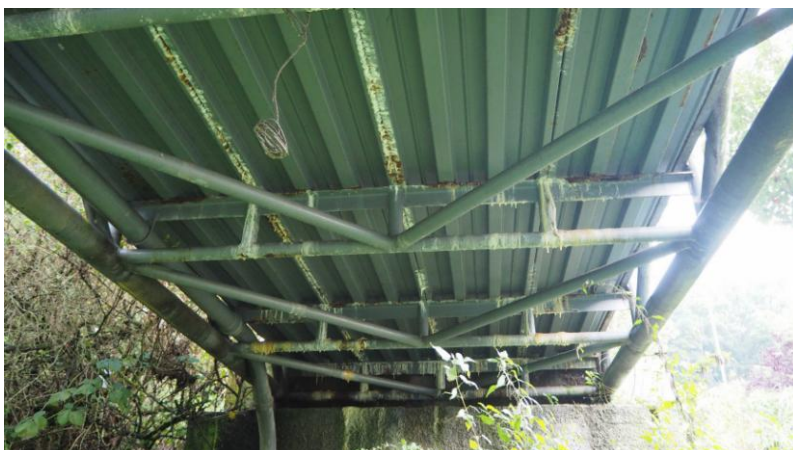
Podhled nk s průsaky a korozí na pravobřežním poli.
