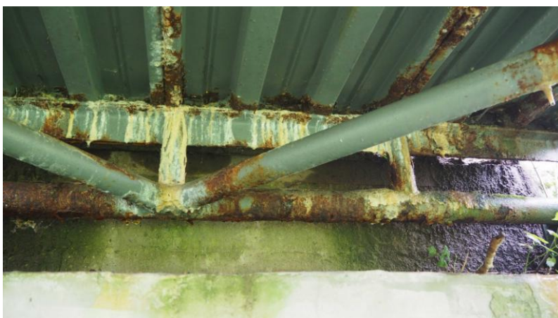
Zkorodovaný koncový příčník na levobřežní opěře.
