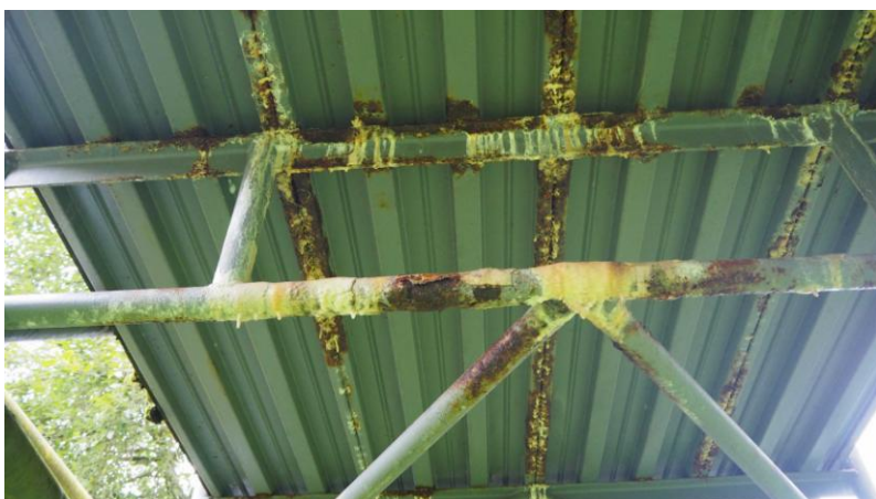
Podhled nk s průsaky a korozí na levobřežním poli.
