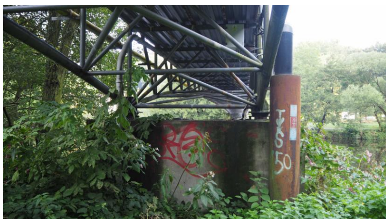
Levobřežní pilíř zarostlý vegetací a se známkami zatékání.
