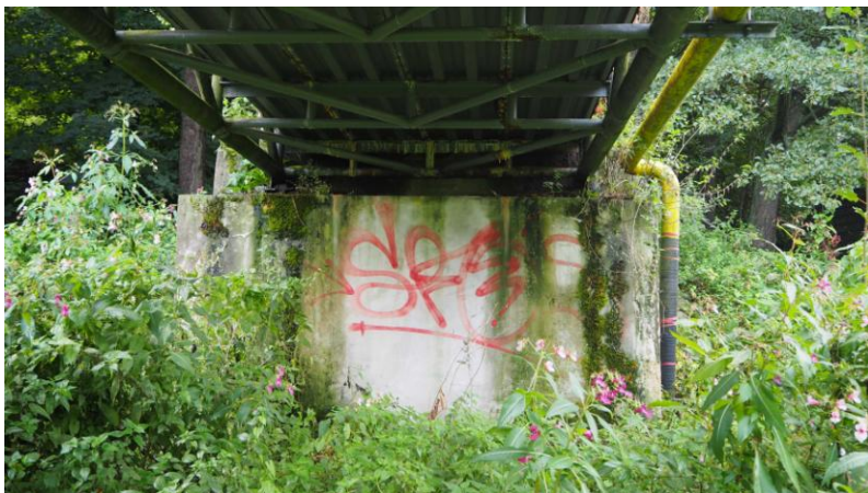
Levobřežní opěra s bujnou vegetací a zatékáním na úložný práh.
