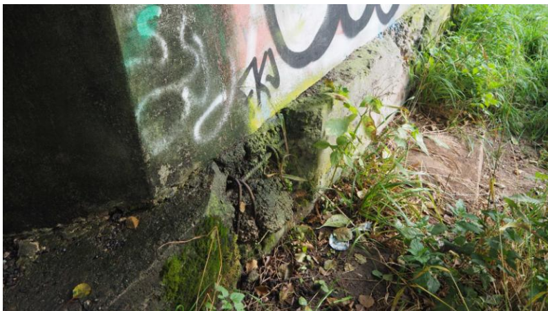
Obnažený základ pravobřežního pilíře s obnaženou korodující výztuží.
