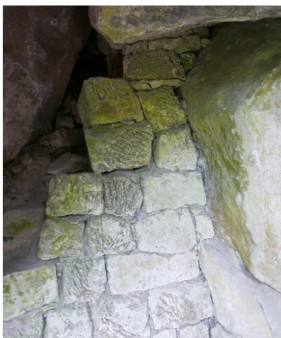
Obr.4 Zřícená opěrná zídka v kaverně pod skalním blokem nalevo od brány (viz obr.2)
