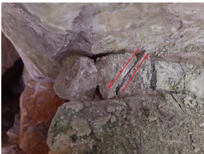
Obr.5 Detail porušení kamene opěrné zídky na styku s dosedajícím blokem. Bohaté solné výkvěty a krusty jsou patrné na původních blocích pískovce i opěrné zdi.
